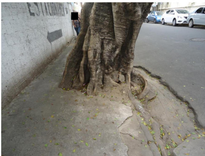
Figura 2 - Árvore situada em frente ao nº 547 obstruindo o passeio
