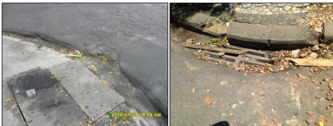
Figura 19 - Situação Atual: Caixas tipo boca-de-lobo obstruída. Linha d' água obstruída por vegetação e lixo.
