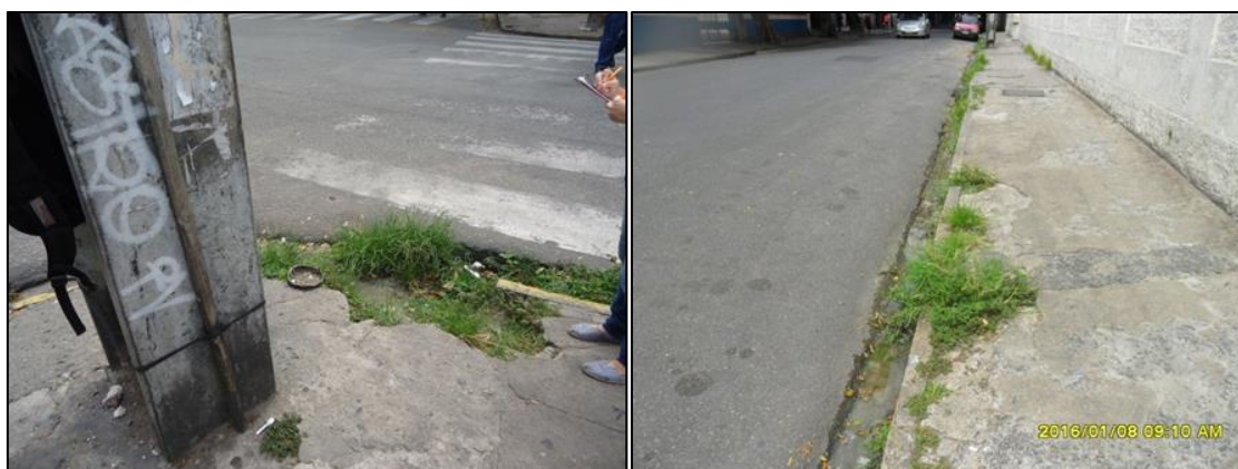
Figura 18 - Situação Atual : Obstrução da linha d'água por vegetação, podendo comprometer a capacidade hidráulica e dificultando o escoamento das águas pluviais.
