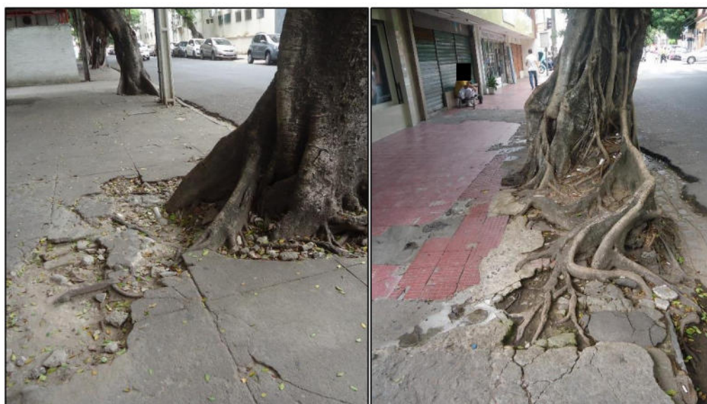
Figura 16 - Pavimento danificado por raízes de árvores
