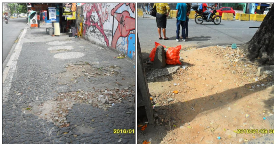
Figura 15 - Pavimento em pedra portuguesa danificado
