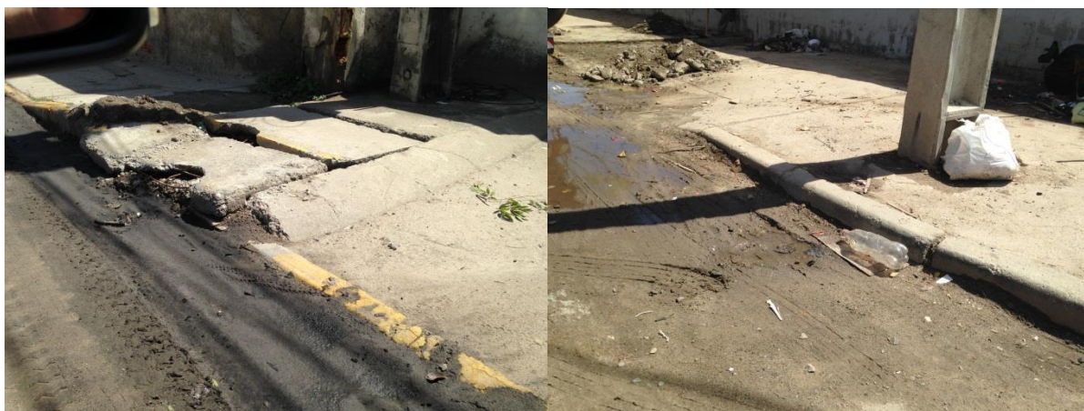
Figura 17 – Situação Atual : Caixas tipo gaveta com tampa quebrada e bastante obstruída, provocando a obstrução da linha d' água.
