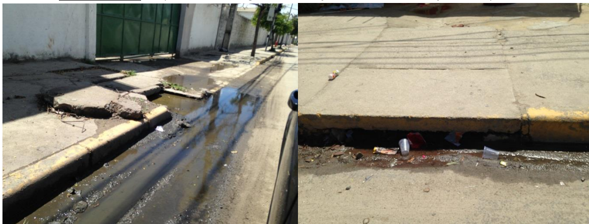
Figura 16– Situação Atual : Caixas tipo gaveta com tampa quebrada e bastante obstruída, provocando o alagamento da linha d' água. E caixa tipo gaveta obstruída por lixo.
