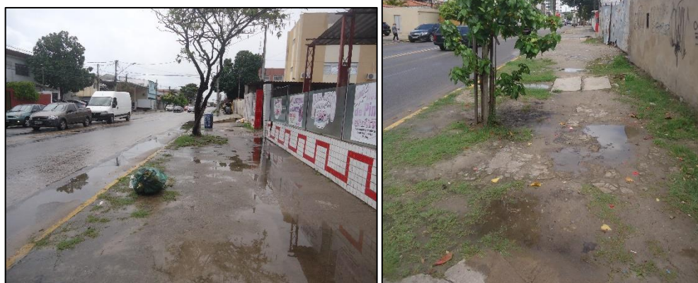
Figura 12 - Pavimento danificado / Figura 13 - Pavimento danificado pelas raízes de árvores
