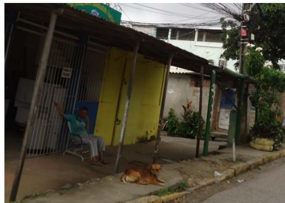
Figura 2 – Piso deteriorado, com descontinuidade do passeio (Fonte: Future ATP – MAI/2021)
