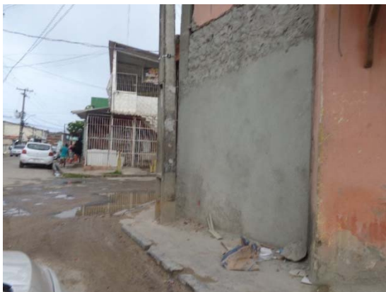
Figura 1 – Ausência de passagem, com poste obstruindo o passeio (Fonte: Future ATP – MAI/2021)
