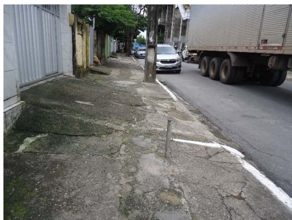
Figura 5 – Balizador de ferro e rampa de veículos obstruindo o passeio
