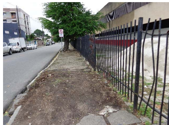
Figura 2 – Ausência de revestimento na calçada, com descontinuidade do passeio (Fonte: Future ATP – MAI/2021)
