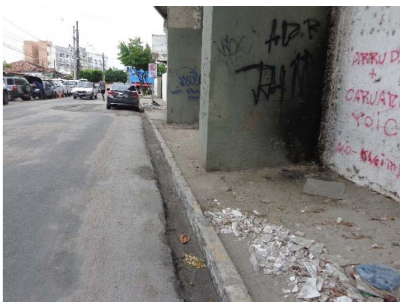
Figura 3 – Ausência de passagem, com descontinuidade do passeio (Fonte: Future ATP – MAI/2021)
