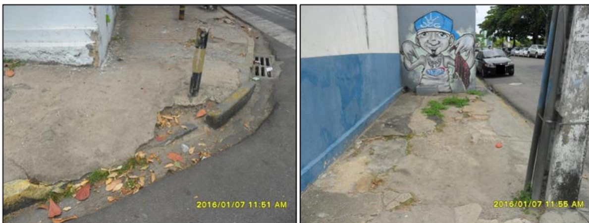
Figura 17 - Situação Atual : Linha d' água com folhas, podendo provocar obstrução da caixa tipo boca-de-lobo. Calçada a ser ampliada.
