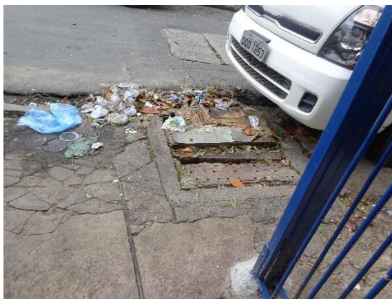
Figura 1 – Caixa de drenagem danificada (Fonte: Future ATP – MAI/2021)
