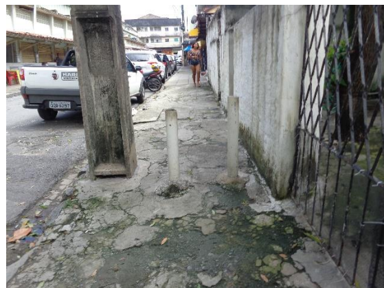
Figura 4 – Balizadores de ferro obstruindo o passeio (Fonte: Future ATP – MAI/2021)
