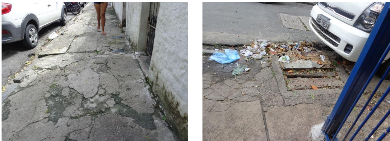
Figura 16 - Drenagem: Caixa coletora obstruída (Fonte: Future ATP – JAN/2021)
