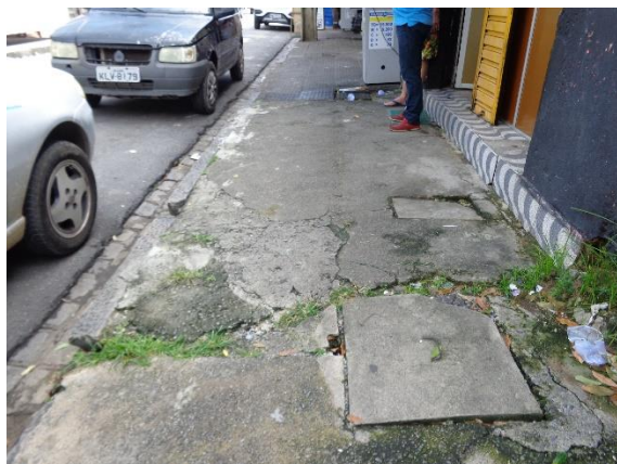
Figura 3 – Piso deteriorado (Fonte: Future ATP – MAI/2021)
