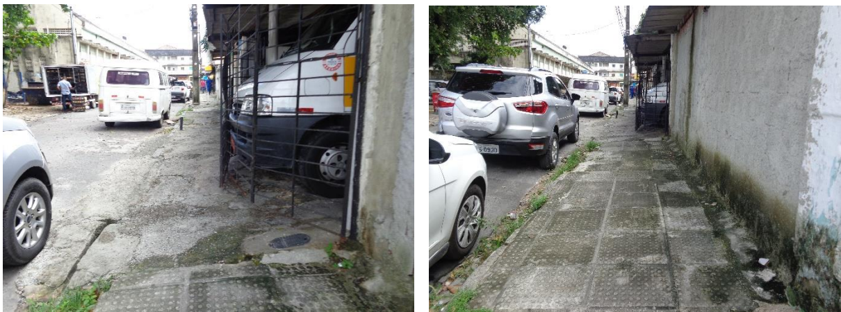
Figura 15 - Drenagem: linha d'água obstruída (Fonte: Future ATP – JAN/2021)
