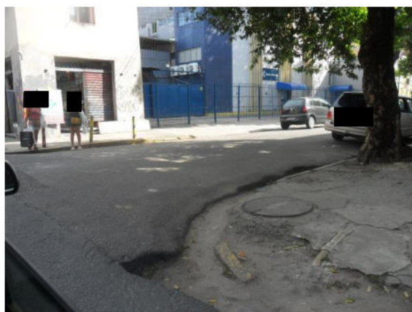
Figura 24 - Situação Atual : Pavimento com erosão, provocada pela destruição do meio-fio e comprometimento da calha da linha d' água.
