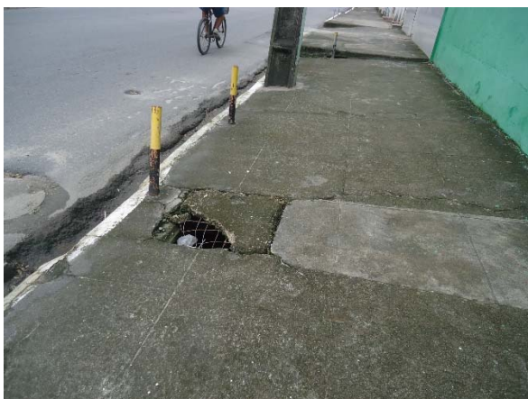
Figura 3 – Caixa de inspeção quebrada obstruindo o passeio (Fonte: Future ATP – MAI/2021)
