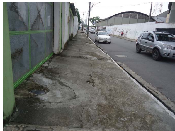
Figura 2 – Piso deteriorado, com descontinuidade do passeio (Fonte: Future ATP – MAI/2021)
