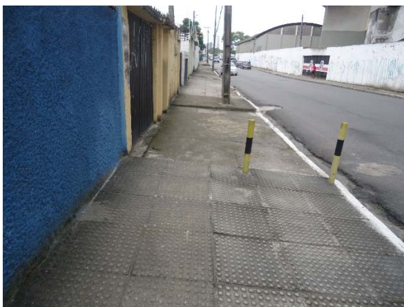
Figura 1 – Desnível entre calçadas obstruindo o passeio (Fonte: Future ATP – MAI/2021)
