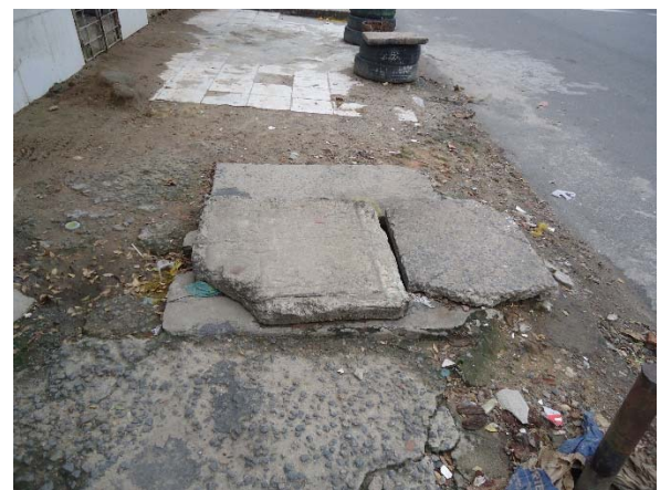
Figura 4 – Caixas de drenagem danificadas, com ausência de revestimento obstruindo o passeio (Fonte: Future ATP – MAI/2021)
