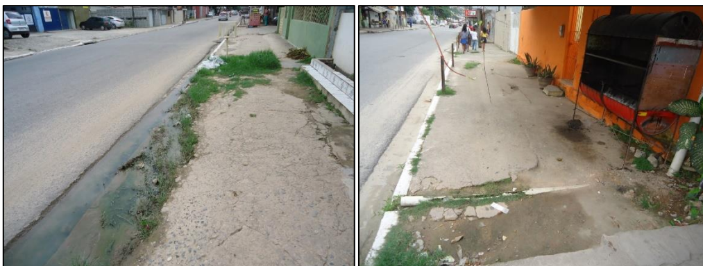
Figura 12 - Pavimento danificado e invadido por vegetação / Figura 13 - Pavimento danificado
