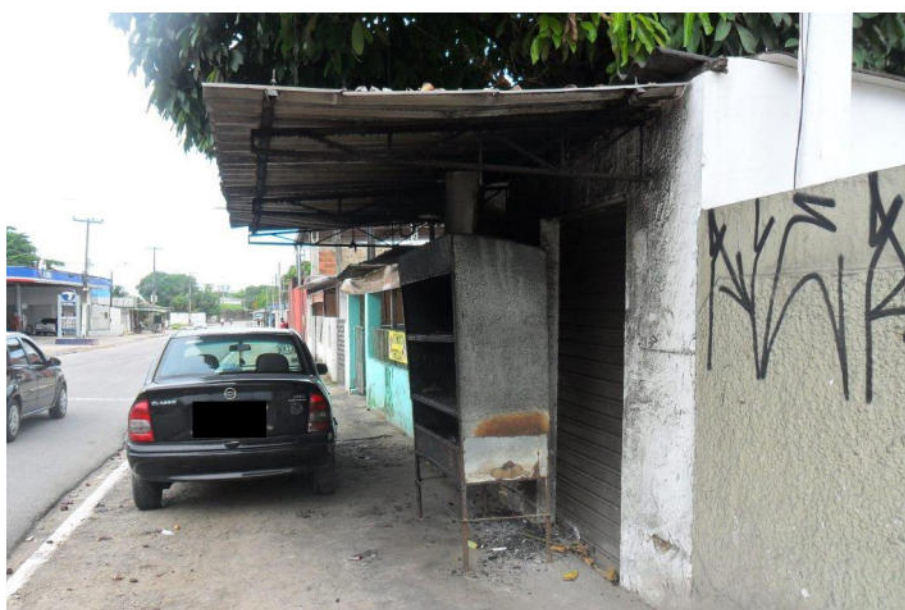
Figura 3 - Barracas de comércio com cobertas obstruindo o passeio
