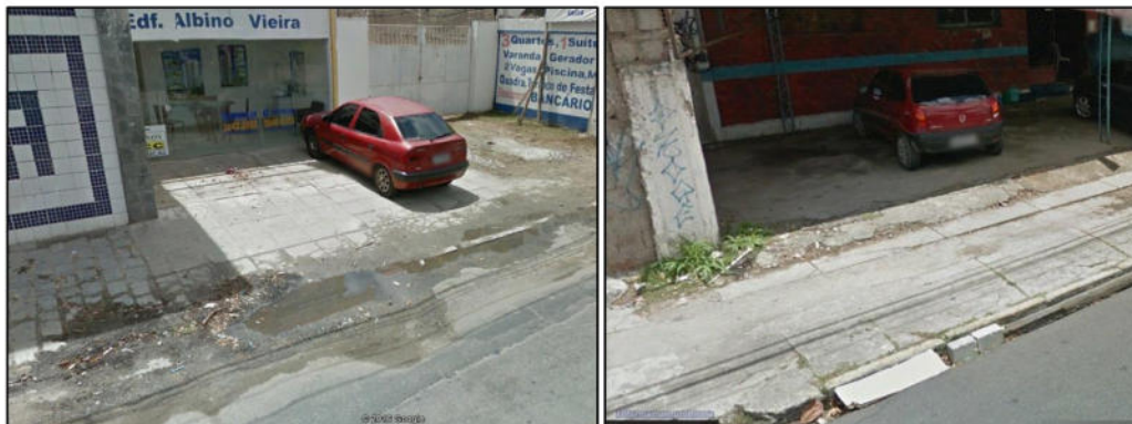
Figura 24 - Situação Atual : Pontos de obstruções que provocam alagamentos, devido as rampas de acesso aos estabelecimentos. Recomendações : Limpeza de linha d' água. Onde houver as rampas de acesso considerar uma calha de 10cm de largura, para não comprometer o escoamento da água.
