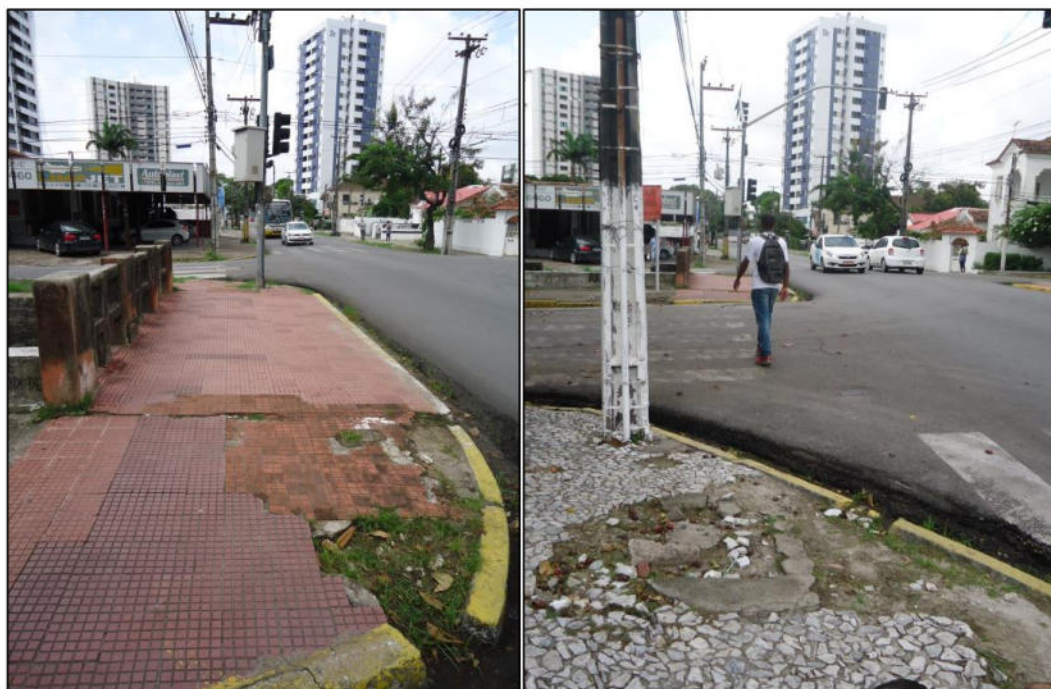
Figura 12 - Pavimento em ladrilhos danificado / Figura 13 - Pavimento em pedra portuguesa danificado
