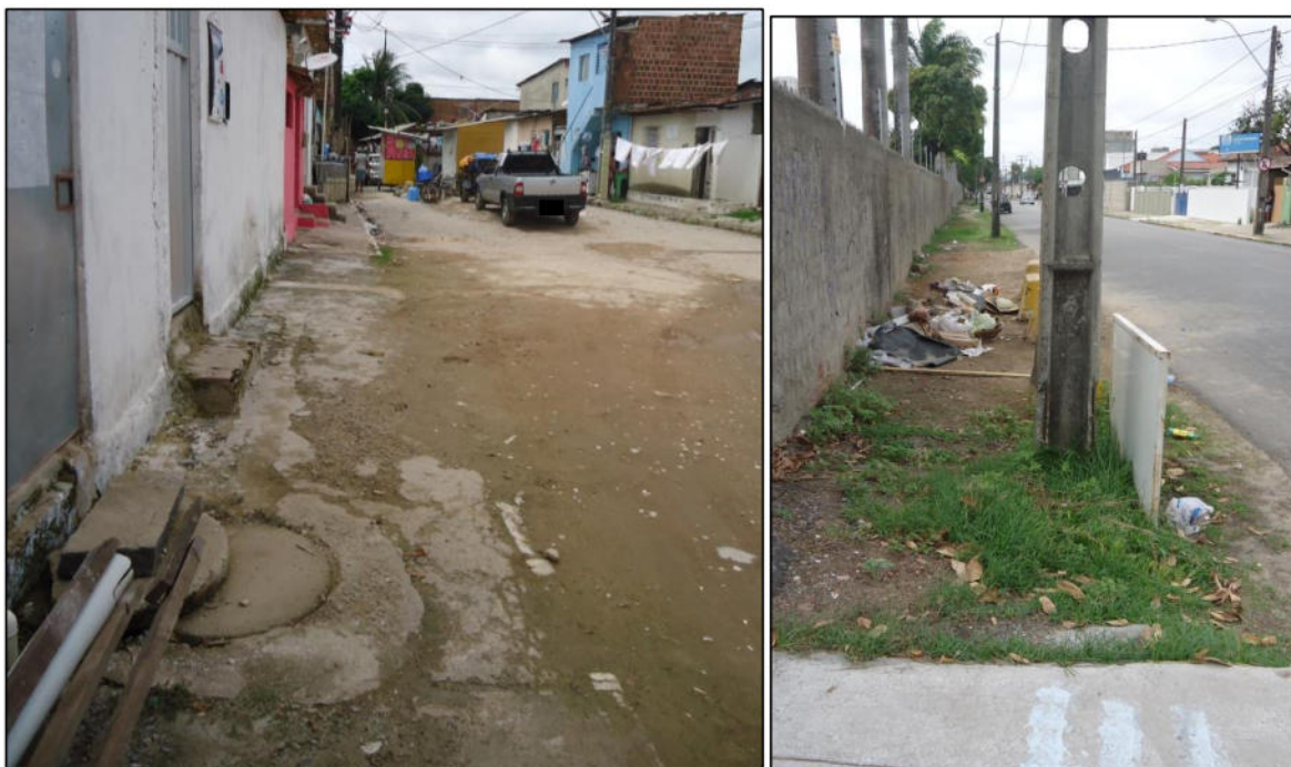
Figura 14 - Inexistência de pavimento no passeio
