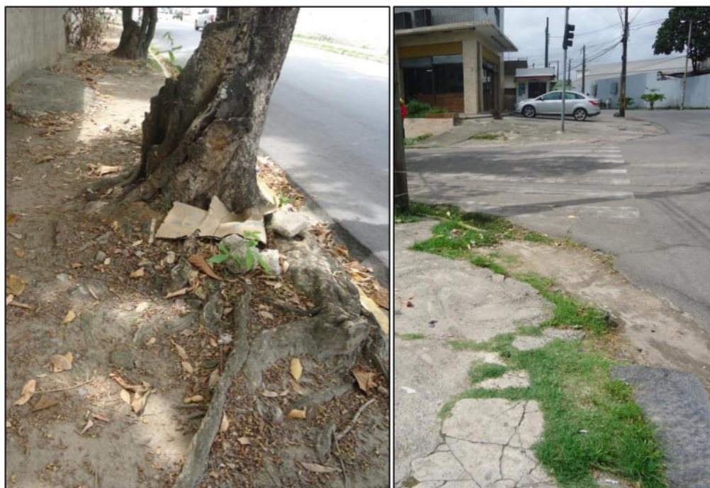
Figura 15 - Invasão da vegetação / Figura 16 - Invasão de raízes no pavimento
