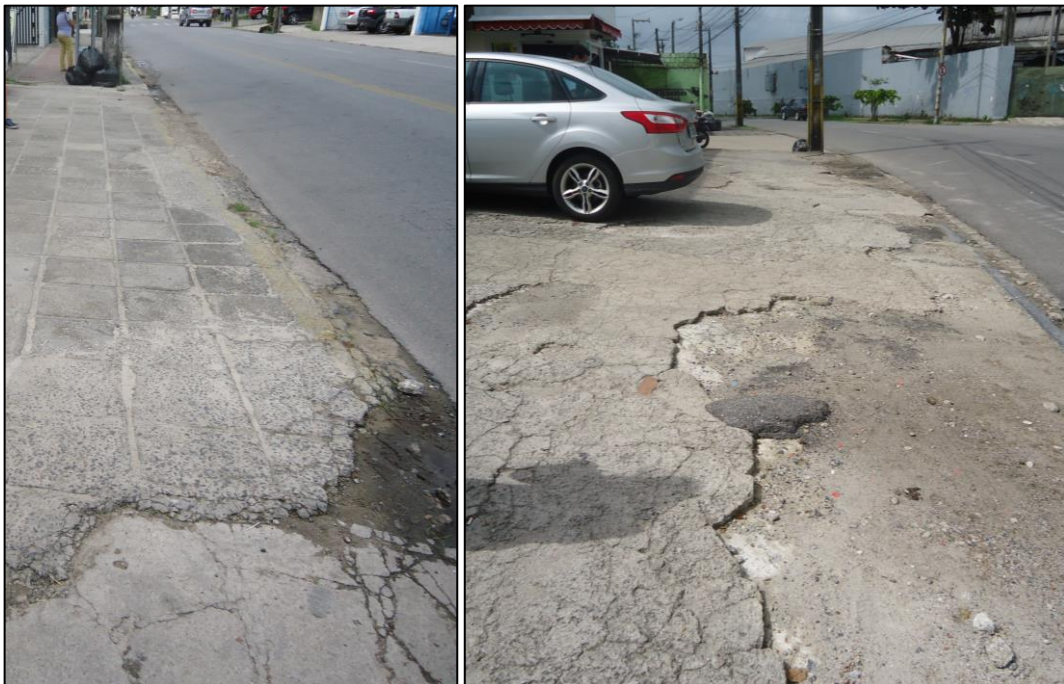
Figura 10 - Pavimento em cimentado danificado / Figura 11 - Pavimento em lajotas danificado
