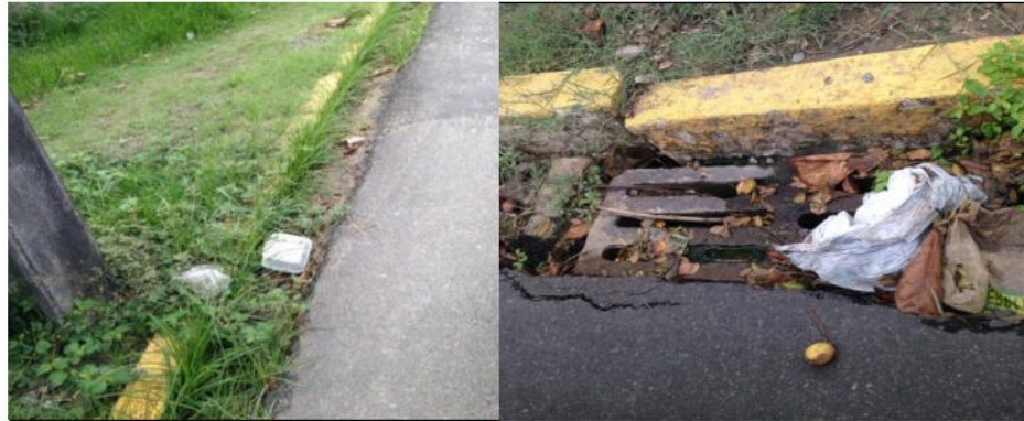
Figura 22 - Situação Atual : Linha d' água obstruída por vegetação e lixo. Tampa quebrada da caixa coletora tipo boca-de-lobo e obstruída por vegetação e lixo Recomendações : Limpeza da linha d' água. Reconstrução da tampa da caixa (0,30 x 0,90) e limpeza da caixa
