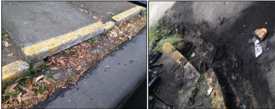
Figura 23 - Situação Atual : Caixa tipo gaveta com tampa quebrada e obstruída. Linha d' água obstruída por vegetação, comprometendo a seção hidráulica e podendo acarretar alagamento e obstrução das caixas coletoras Recomendações Reconstrução da tampa da caixa (1,40 x 1,40), e limpeza da caixa. E limpeza da linha d' água.
