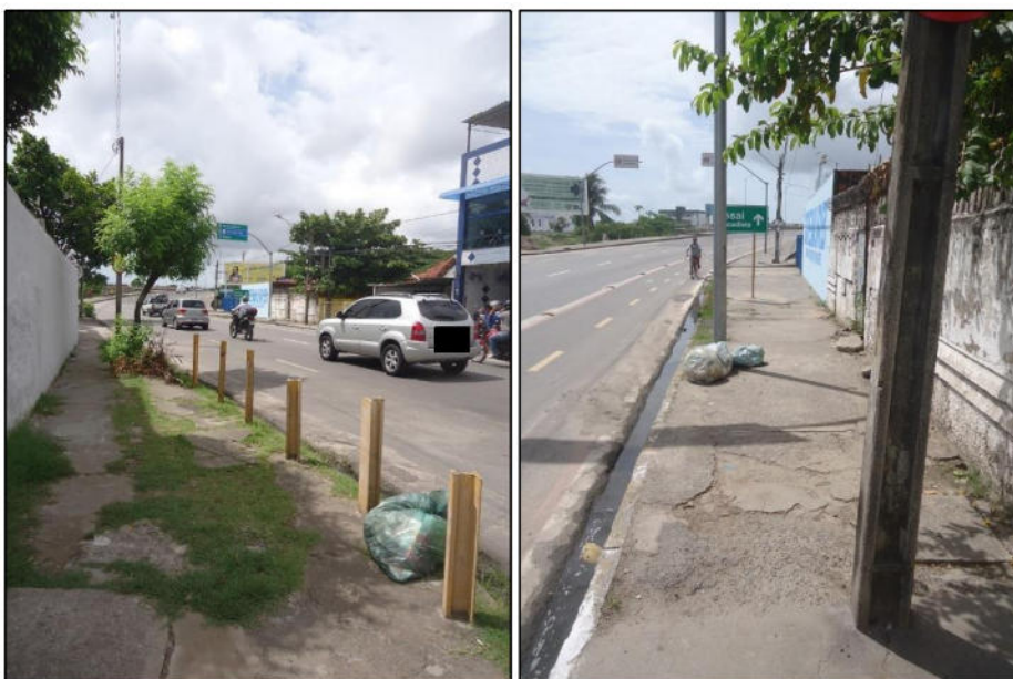
Figura 6 - Pavimento danificado e invadido por vegetação / Figura 7 - Pavimento danificado
