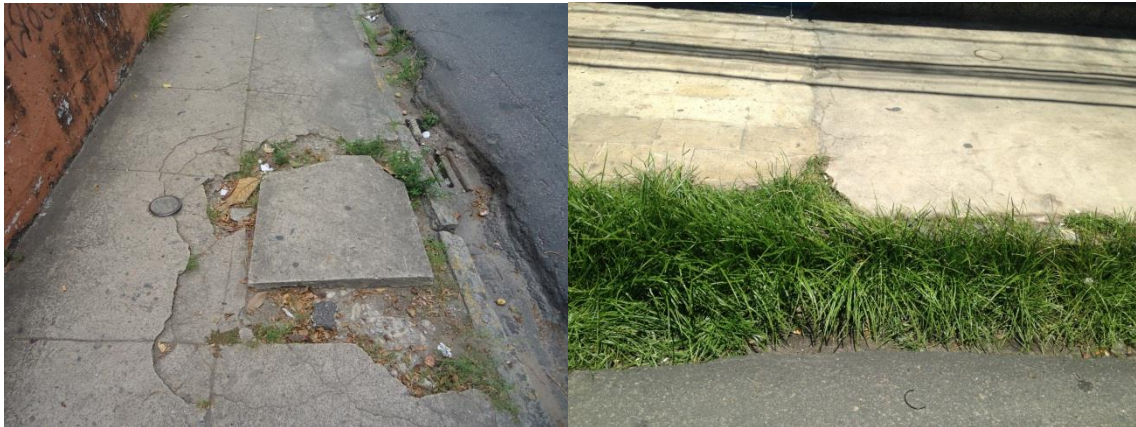
Foto 1 – Situação Atual: Tampas quebradas e linha d' água obstruída por vegetação.
