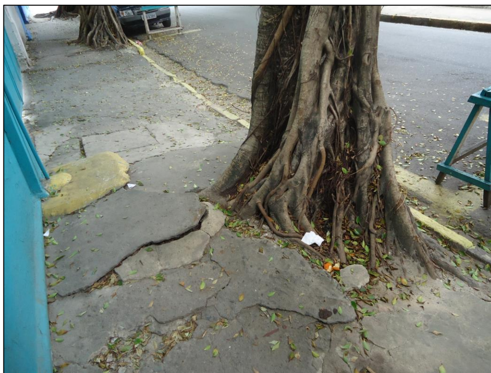
Figura 5 - Raiz de Árvore Destruindo o Revestimento
