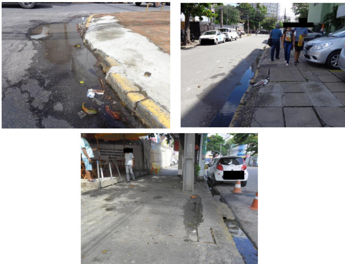
Figura 10 - Situação Atual : Linha d'água destruída e obstruída por rampa de acesso aos estabelecimentos, podendo provocar pontos de alagamentos. E caixa com tampa quebrada.
