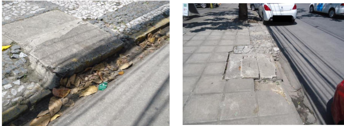
Figura 9 - Situação Atual : Linha d'água e caixa obstruídas, por vegetação, podendo provocar pontos de alagamentos. E caixa com tampa quebrada.
