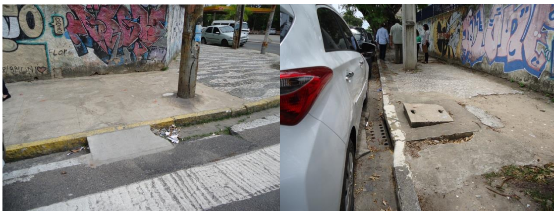
Foto 1 – Situação Atual: Construção de rampa de acesso, provocando obstrução na linha d' água .Tampa fora do lugar e caixa tipo boca-de-lobo obstruída por vegetação.
