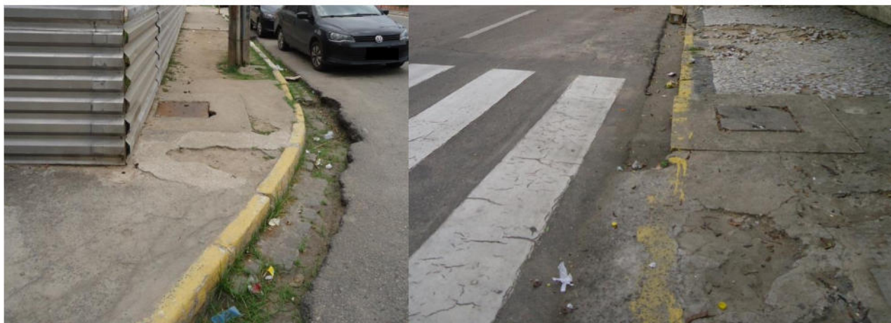
Foto 3 – Situação Atual: Linha d' água obstruída por rampa de acesso e vegetação. Pavimento apresentando erosão. Recomendações: Limpeza de linha d' água. Onde houve as rampas de acesso considerar uma calha de 10cm de largura, para não comprometer o escoamento da água.
