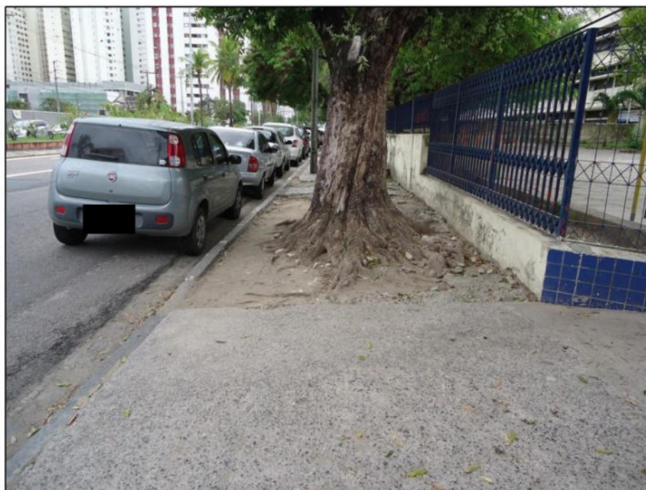
Figura 13 - Raiz de Árvore Destruindo o Revestimento
