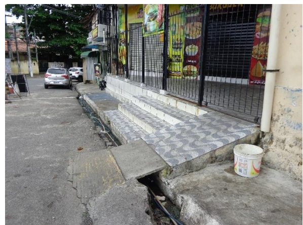
Figura 2 – Degraus e rampa de acesso de pedestre obstruindo o passeio (Fonte: Future ATP – MAI/2021)
