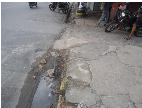
Figura 1 - Piso deteriorado (Fonte: Future ATP – MAI/2021)
