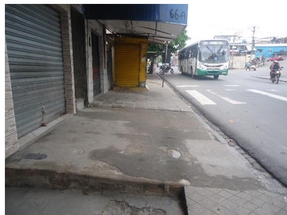
Figura 4 – Desnível entre calçadas com descontinuidade do passeio (Fonte: Future ATP – MAI/2021)
