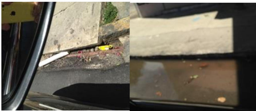
Figura 13 - Seção – Situação Atual : Caixas tipo gaveta com tampa bastante obstruída por lixo, com tampa bastante obstruída por lixo, provocando pontos alagamento da linha d' água. Recomendações . Desobstruções da caixa, reconstrução da tampa. E limpeza de linha d' água.
