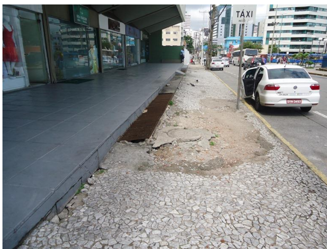
Figura 10 - Pavimento danificado / Figura 11 - Pavimento danificado
