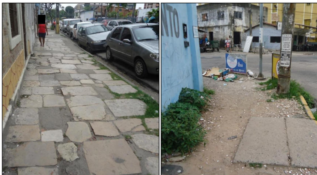
Figura 14 - Pavimento em pedra de Lioz / Figura 15 - Ausência de pavimento
