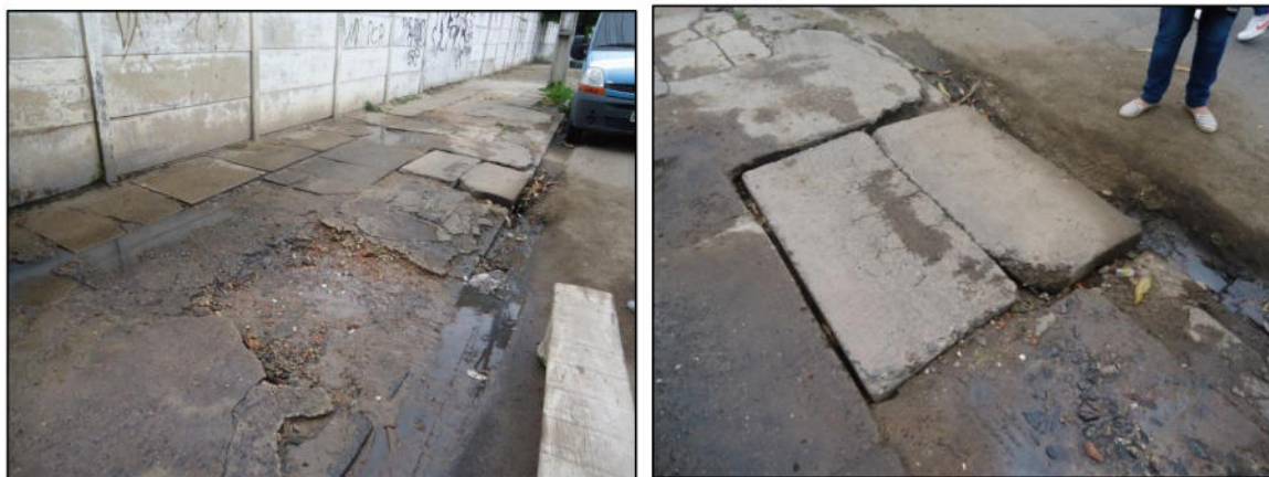
Figura 22 - Situação Atual : Caixa coletora tipo gaveta com tampa quebrada e obstruída. Caixa tipo boca-de-loe obstruída por lixo e tampa quebrada.
