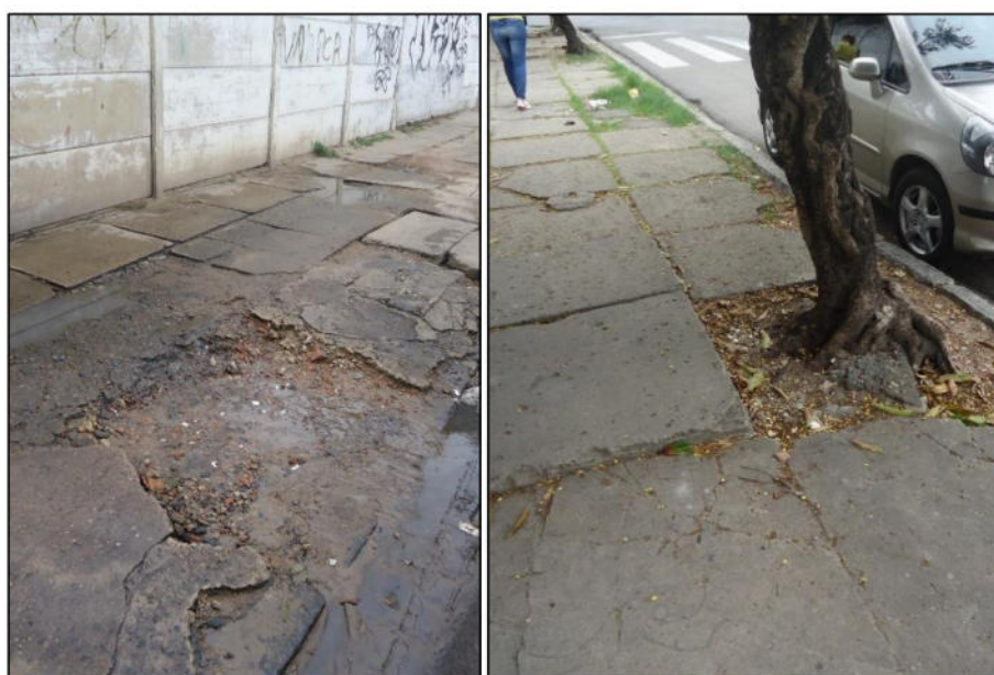
Figura 16 - Pavimento danificado / Figura 17 - Pavimento danificado pelas raízes da árvore
