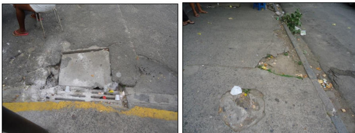
Figura 24 - Situação Atual : Linha d' água obstruída por lixo, comprometendo a seção hidráulica e podendo acarretar alagamento e obstrução das caixas coletoras.
