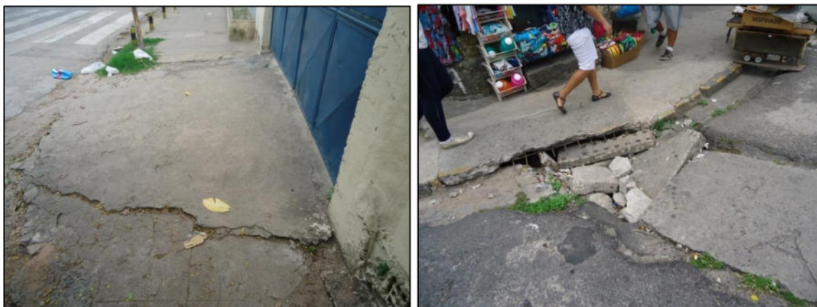
Figura 23 - Situação Atual : Pontos de obstruções que provocam alagamentos, devido às rampas de acesso aos estabelecimentos. Tapa da boca-de-lobo destruída.
