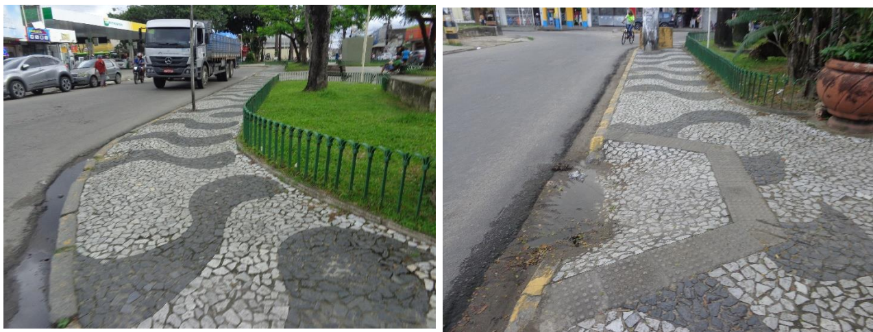
Figura 14 - Drenagem: linha d'água obstruída (Fonte: Future ATP – JAN/2021)
