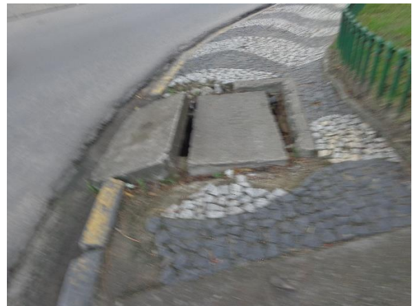
Figura 2 – Caixa de drenagem danificada obstruindo o passeio (Fonte: Future ATP – MAI/2021)
