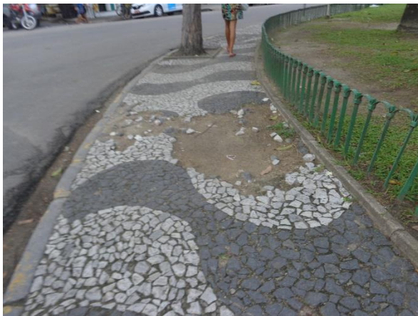
Figura 1 - Piso deteriorado obstruindo o passeio (Fonte: Future ATP – MAI/2021)
