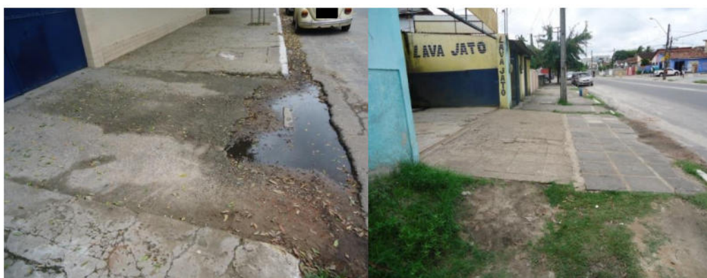
Foto 3 – Situação Atual: Pontos de obstruções que provocam alagamentos, devido as rampas de acesso aos estabelecimentos.
