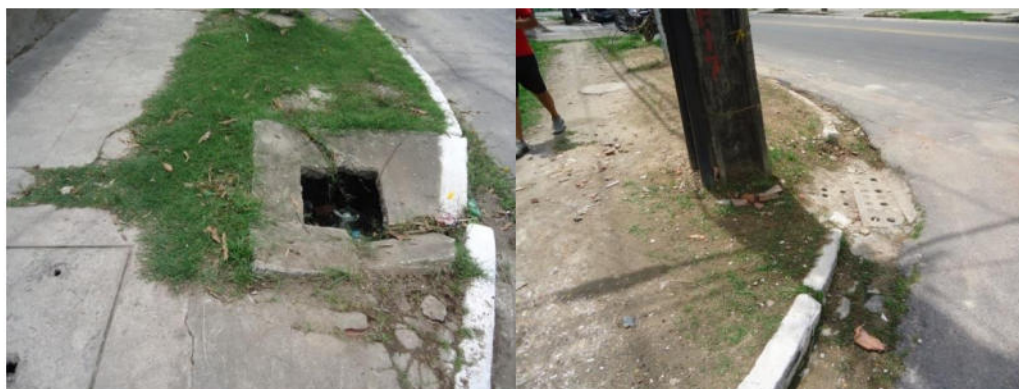
Foto 2 – Situação Atual: Caixa tipo gaveta com tampa totalmente destruída, provocando a obstrução. Boca-de-lobo obstruída por vegetação.
