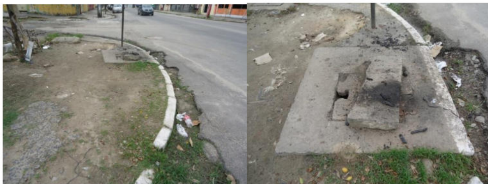
Foto 1 – Situação Atual: Linha d' água obstruída por vegetação e Tampa quebrada da caixa coletora tipo gaveta e obstruída. e linha d' água obstruída por vegetação.
