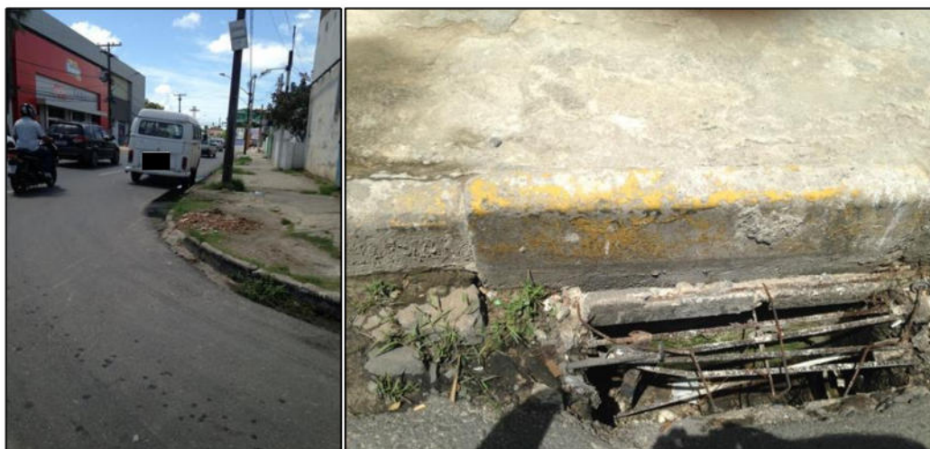
Figura 9 - Situação Atual : Linha d' água obstruída por vegetação. Caixa tipo boca-de -lobo totalmente destruída a tampa.
