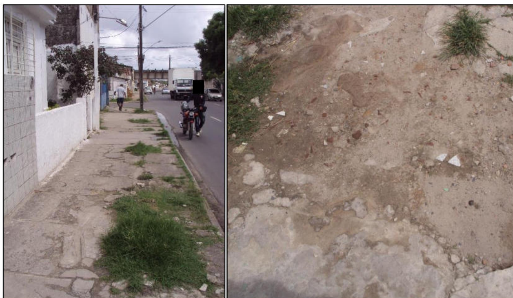
Figura 6 - Pavimento invadido pela vegetação / Figura 7 - Pavimento danificado
